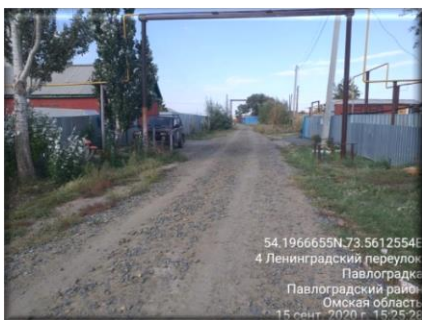
Нарушение уплотнения щебеночного основания на автодороге по пер. Ленинградский в р.п. Павлоградка
