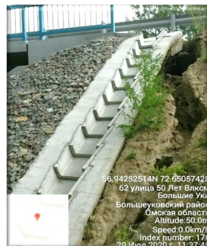
Размывание грунта в основании моста через реку Большой Ук
