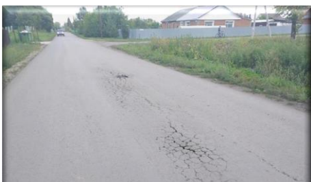
Разрушения асфальтобетонного покрытия на ул. Больничная в пос. Омский
